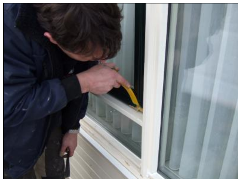
Houtrotsanering en bouwkundige werkzaamheden vallen onder 19% BTW
